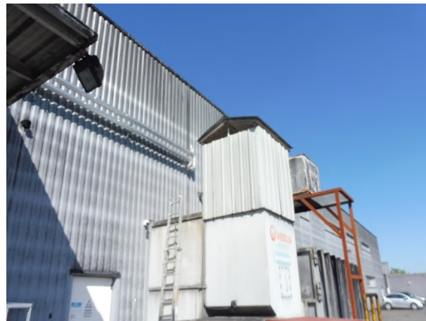
Dispositif de traitement d'air
